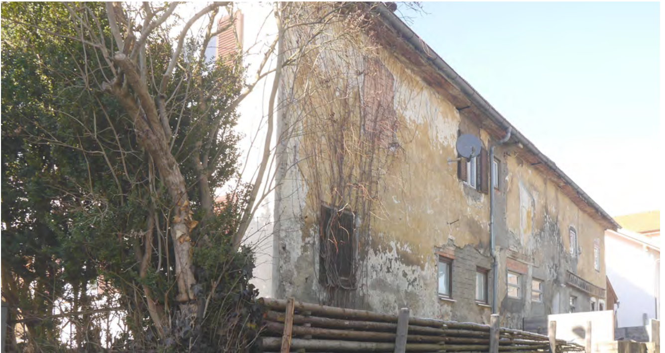
Abb. 39: Bestandsgebäude mit erheblichen Erhaltungsmängeln | Retscherstraße
